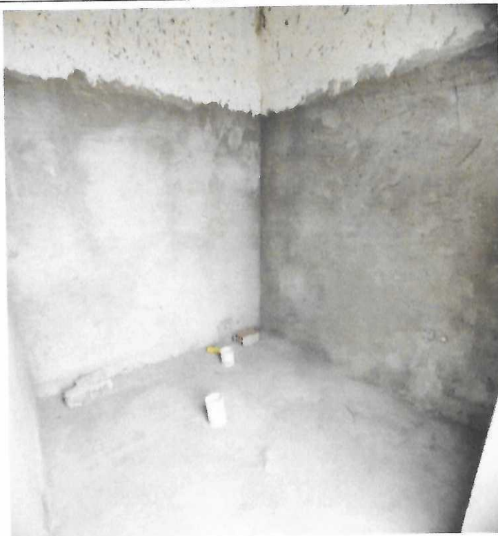
Imagem 19 - Ponto de água fria embutido, c/material pvc rígido soldável Ø 25 mm - Bloco Camarote.
