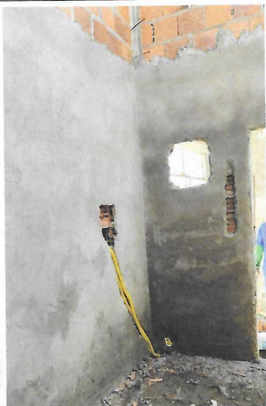
Imagem 14 - Eletroduto de pvc rígido roscável, diâmetro = 25mm (3/4") - Bloco Vestiário de Times.
